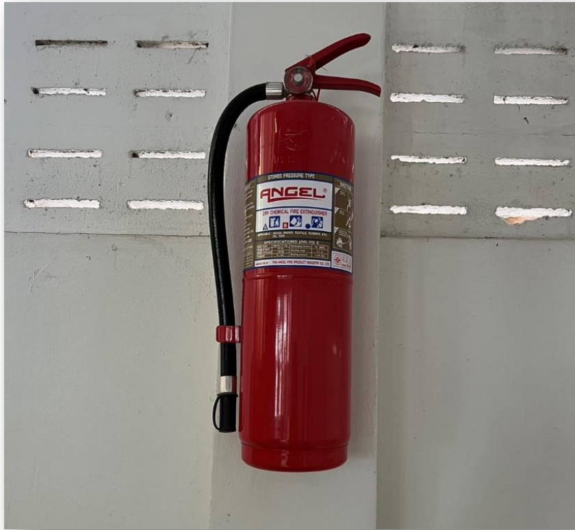
ถังดับเพลิง เพื่อป้องกันการเหตุอัคคีภัย
